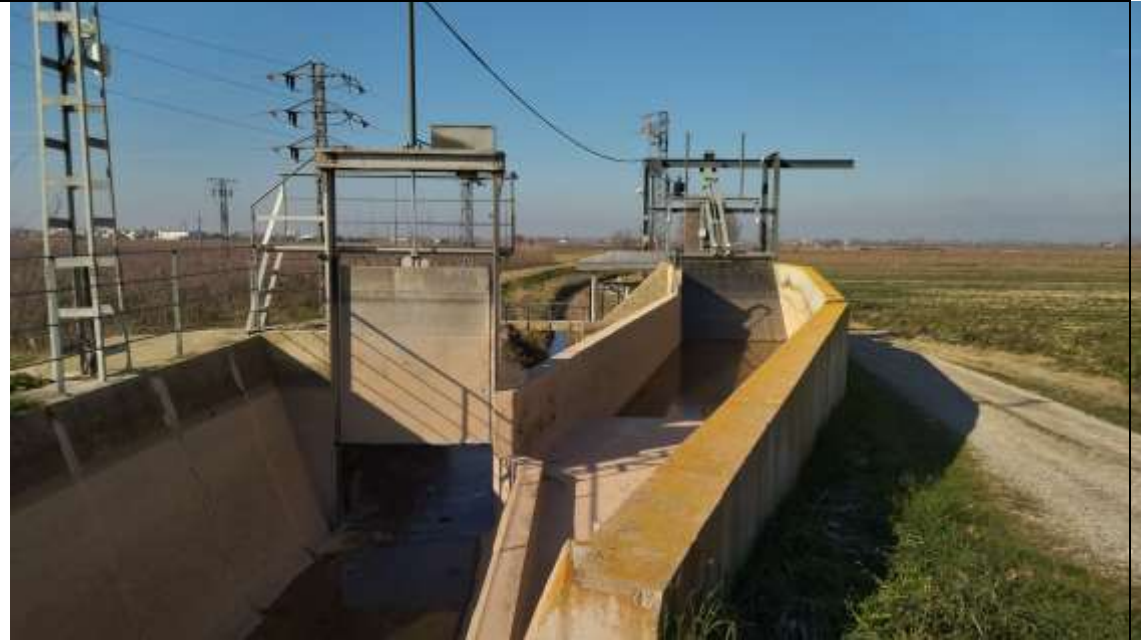
Figura 21. Central Barbens_01 Vista detall posterior dels salts
